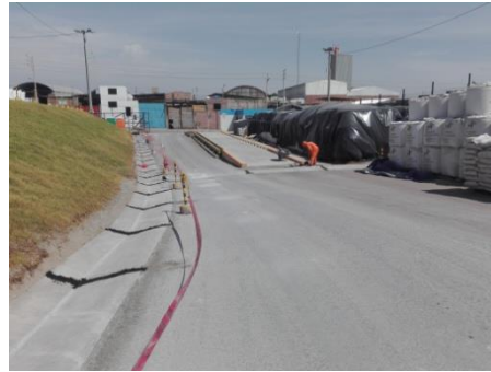
Cunetas – Drenajes Pluviales
